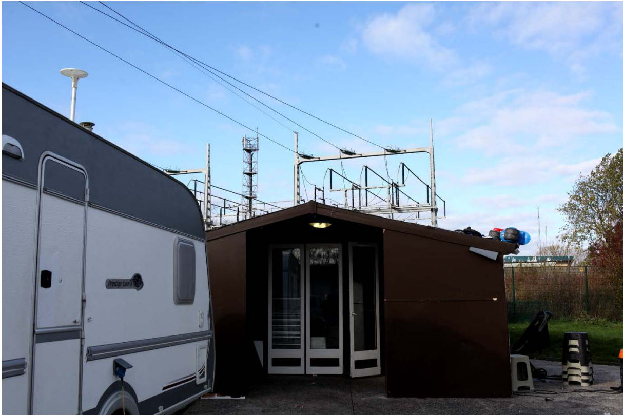
Vue depuis un emplacement de l'aire de Seclin positionné sous la ligne à haute tension reliée au transformateur
