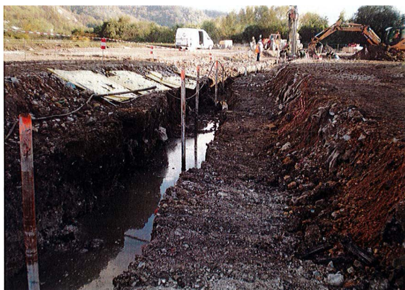
Travaux de réfection de l'aire d'accueil de Sotteville-lès-Rouen (image du maître d'œuvre)
