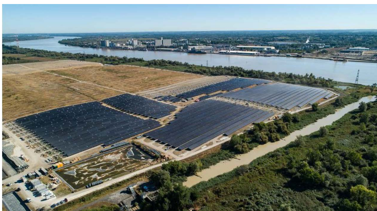
Chantier d'installation de 140 000 panneaux photovoltaïques sur l'ancienne décharge de Labarde à Bordeaux
